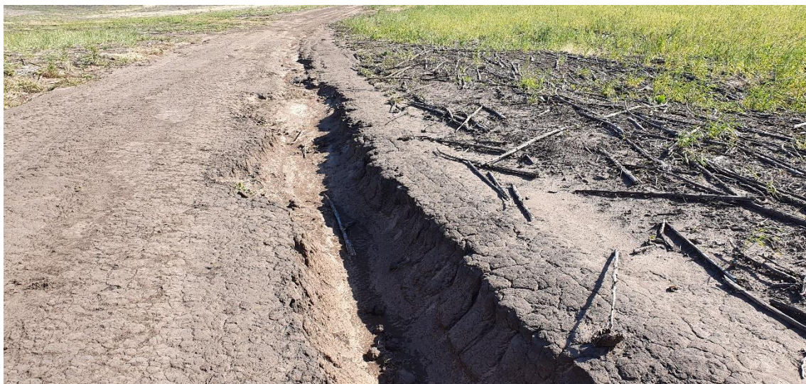
Imagen 11. Carcava de erosión contigua a camino interno (37°42'59.38"S; 58°59'27.24"O)
